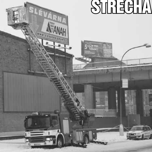
Nevydržela přival sněhu. Hasiči v sobotu krátce po poledni likvi- dovali následky po pádu střechy slévárny. Foto: Martin Zaoral
