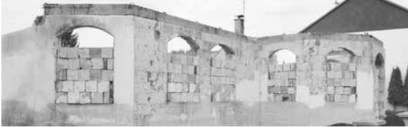
Zbyla jen ruina. Majitelka tohoto vypáleného domu Aloisie Finková potvrdila, že peníze z pojistky investuje do renovace nemovitosti. Foto: Michal Kadlec
