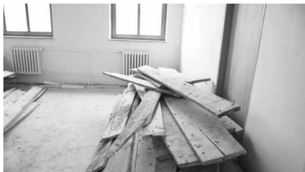
Největší problém. Dřevěné podlahy v budově B prostějovské radnice napadly houby a paraziti. Foto: Magistrát města Prostějova.
