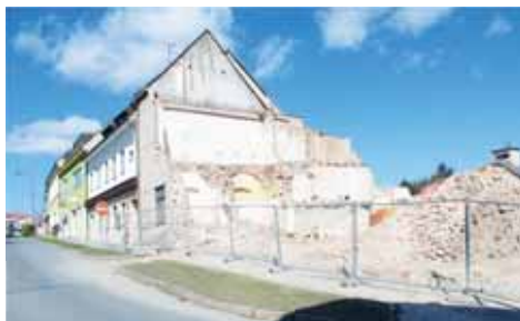
Demolice bývalé Kožetvorby v dolní části konického náměstí proběhla již před téměř třemi roky. I na tomto místě by měl vyrůst obchod s potravinami řetězce CBA. Foto: archiv Večerníku
