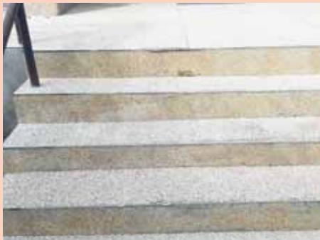
Schody do bytového domu poškodili pracovníci, kteří v jednom z bytů měnili okna. Foto: Kristýna Bohatová
