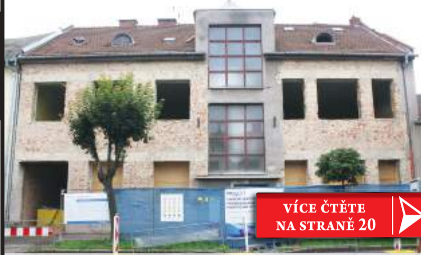
Takto vypadá zchátralá budova Marty při pohledu z Martinákovy ulice. Foto: Martin Zaoral
