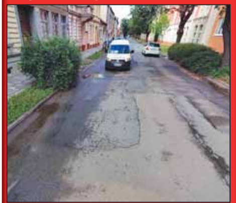
V Českobratrské ulici je ve špatném stavu silnice, lépe na tom nejsou ani chodníky. Foto: Magistrát města Prostějova
