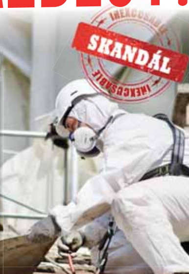
Rekonstrukci mateřinky v Čechovicích zbrzdil kromě jiného i nález azbestu ve stěnách dvou pavilonů. Ilustrační foto: internet
