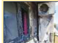
V paneláku v Okružní ulici hořely balkony. Kvůli klimatizaci!
