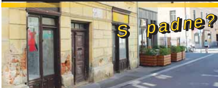
Stav domu v Kravařové ulici je žalostný a neustále se zhoršuje.
