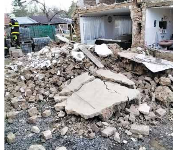
Zřícená štítová stěna v Dobromilicích našetřila nezáškodlivé žádné zranění. Foto: hzscr.cz
