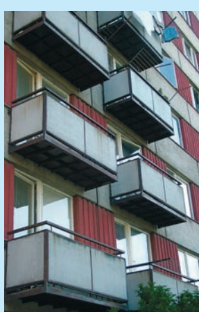
Současný stav balkonů na paneláku v Zrzavého ulici je havarijní. Hrozí jejich zřícení!
