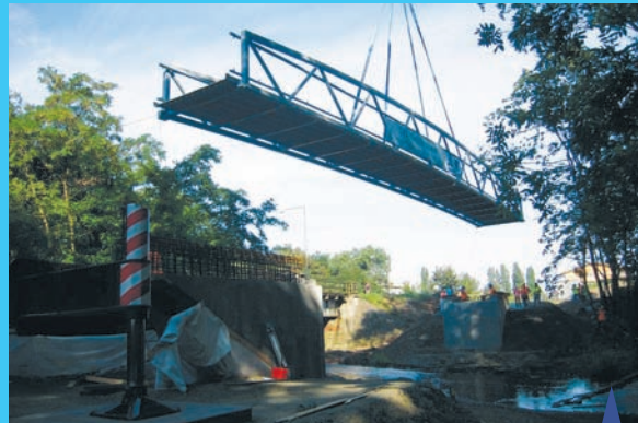
Jeřábek byl také přesný jak švýcarské hodinky. Šestadvacet metrů dlouhý a tři metry široký most pomalíčku sunul k připraveným betonovým pilotům.
