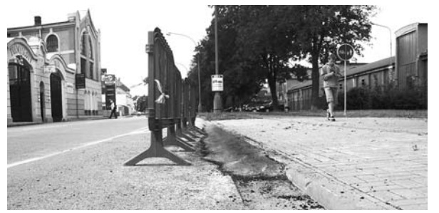
Stačilo málo. Provizorní nájezd na cyklostezku koncem týdne překryl nebezpečný obrubník, kvůli němuž se nejezdící cyklista poroučel k zemi. Stalo se tak až poté, co Večerník na problém upozornil... Foto: Martin Zaoral
