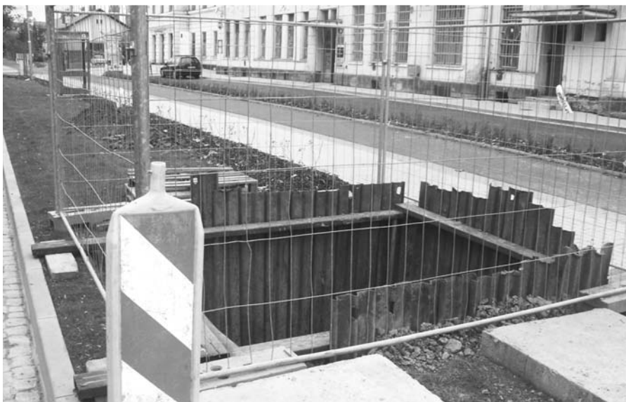
Město za to nemůže. Výkop ve Sladkovského ulici se objevil poté, co České dráhy uznaly svoji chybu při napojení kanalizace vedoucí z budovy místního nádraží. Foto: Michal Kadlec
