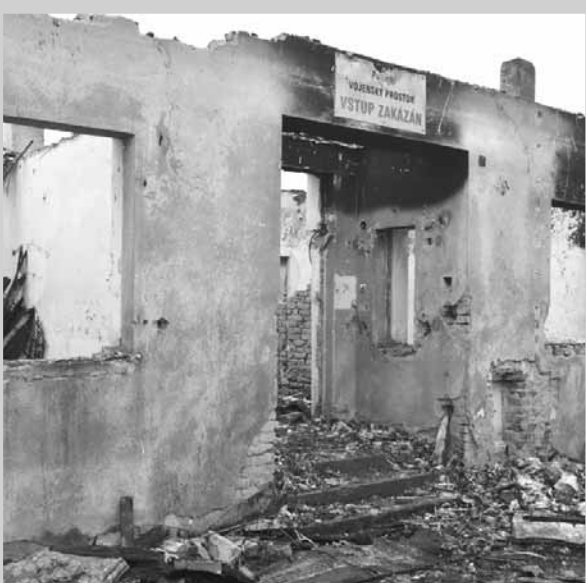
Hledá se viník. Bývalá vojenská telefonní ústředna lehla doslova popelem. Podezření padá na bezdomovce. Foto: Michal Kadlec
