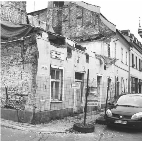
Smutný pohled. Padající omítka, vykuchaný interiér a praskající obvodové zdi. Dají se tyto domy za Priorem ještě vůbec zachránit? Foto: Michal Kadlec
