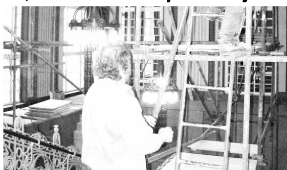
Rekonstrukce pokračuje. Interiér radnice se v těchto dnech změnil v jedno velké staveniště. Foto: Michal Kadlec
