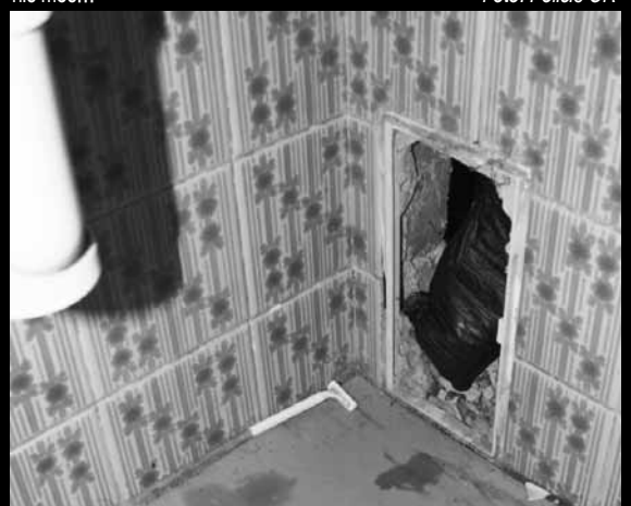
Skrýš. V odpadové šachtě pod vanou v koupelně mladík schovával uloupené peníze. Foto: Policie ČR
