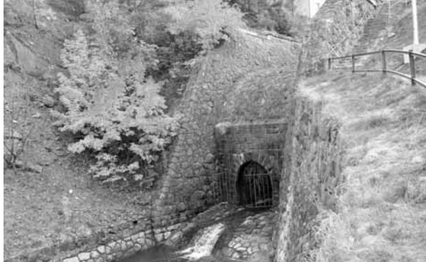
Kontrast. Stav výpusti, mezi ježními kameny prorůstá tráva, ostře kontrastuje se zbytkem nedávno opravené hráze. Škoda, že ji nikdo při příležitosti nákladních oprav hráze alespoň nevyčistil. Foto: Martin Zaoral
