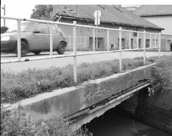
Je v provozu, ale... Most přes mlýnský náhon v Čechovicích je sice v provozu, ale s velkými výhradami. Foto: Michal Kadlec
