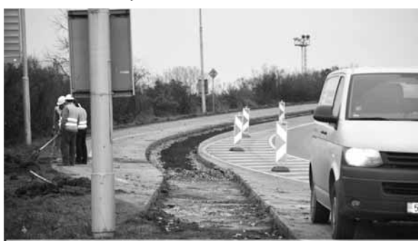
Omyl lidí. Stavební práce na nové cyklostezce nezasahují do nedávno vybudovaného rondelu v Dolní ulici. Foto: Michal Kadlec
