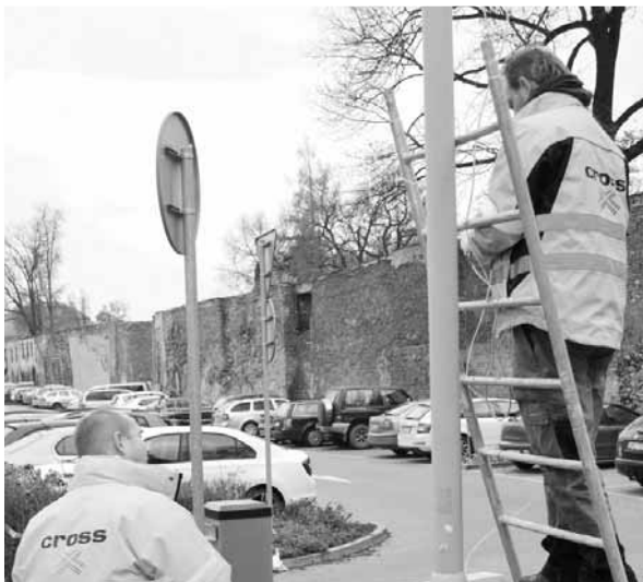
Už ho montují. Pracovníci specializované firmy už v pátek instalovali na parkovišti ve Školní ulici závorový systém. Foto: Michal Kadlec
