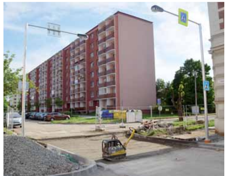
Nové lampy byly na Tylovce postaveny kvůli bezpečnosti chodců. Vzhledem k tomu, že jsou v těsné blízkosti obytných domů, neobejde se to i bez nežádoucích vedlejších účinků. Foto: Martin Zaoral
