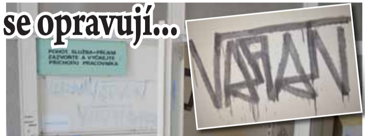
Tag (podpis autora graffiti) „Varan“ se v nesčetných kopiích objevuje na futrech, stěnách i rozbitých okenních výplních po celém objektu bývalé nemocnice v Lidické ulici. Foto: Martin Zaoral
