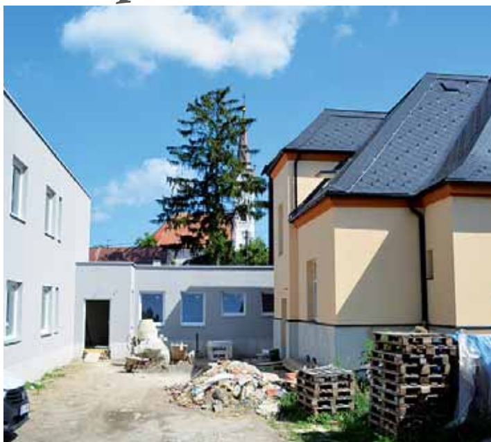
Prostory domu v Západní ulici už opustili i stavební dělníci, Fond ohrožených dětí totiž dluží stavební firmě jedenáct milionů korun. Zalátá tento dluh město a převzme budovu zpět do svého vlastnictví? Foto: Michal Kadlec
