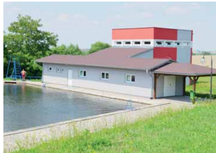
Hasičská zbrojnice v Pavlovicích u Kojetína na první pohled vypadá pěkně. Kvůli špatné stanici a zejména minimálnímu využití však pomalu chátrá. Foto: archiv Večerníku
