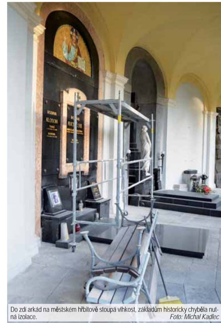
Do zdi arkád na městském hřbitově stoupá vlhkost, základům historicky chyběla nulná izolace. Foto: Michal Kadlec
