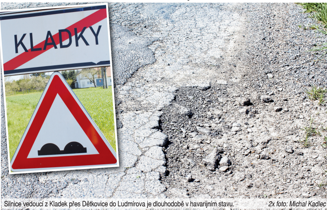
Silnice vedoucí z Kladek přes Dětkovice do Ludmírova je dlouhodobě v havarijním stavu. 2x foto: Michal Kadlec
