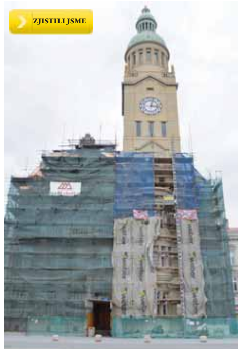
Radniční věž je už zbavena lešení, to bude postupně mizet i z hlavní historické budovy. Foto: Michal Kadlec
