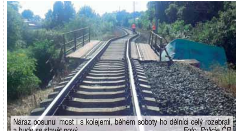
Náraz posunul most i s kolejiemi, během soboty ho dělníci celý rozebrali a bude se stavět nový. Foto: Policie ČR
