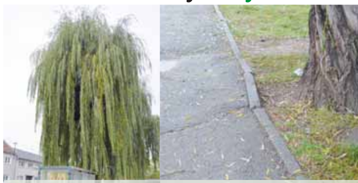
Kvůli kořenům staré vrby nadzvednutý chodník u zastávky ve Vrahovicích už místní nestráší. 2x foto: archiv Večerníku
