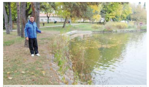
Miroslav Zatloukal poukazuje na špatný stav kamenného obložení rybníka, kterým už zhrsta prorůstají náletové rostliny a dřeviny. Foto: Martin Zaoral
