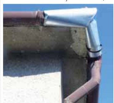
Poškození fasády a okapové roury na domě v Kralickém Háji chtěl řidič kamionu uhradit, pak ale vzal „roha“... Foto: Policie ČR
