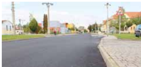
Po rekonstrukci silnice v Nezamyslicích skončily kanály i několik centimetrů pod úroveň nového hrubolátého asfaltu. Okraje silnice přitom zůstávají na několika místech nedodělané. Foto: Martin Zaoral
