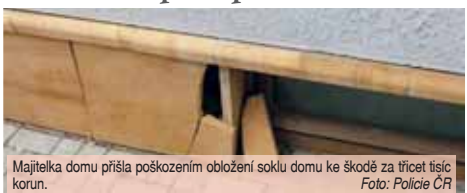
Majitelka domu přišla poškozením obložení soklu domu ke škodě za třicet tisíc korun. Foto: Policie ČR
