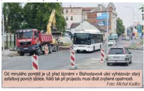
Od minulého pondělí je už před lázněmi v Blahoslavově ulici vyřezávaný starý asfaltový povrch silnice, řidiči tak při průjezdu musí dbát zvýšené opatrnosti. Foto: Michal Kadlec
