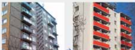
Původní stav bytového domu → havarijní stav balkonů
