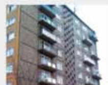
Původní stav bytového domu - havarijní stav balkonů
