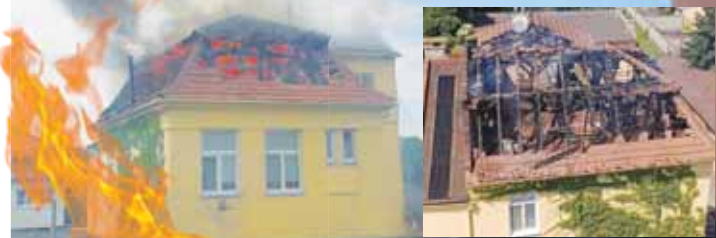
Dvoumilionovou škodu si vyžádal požár střechy domu na Vápenici v Prostějově.
