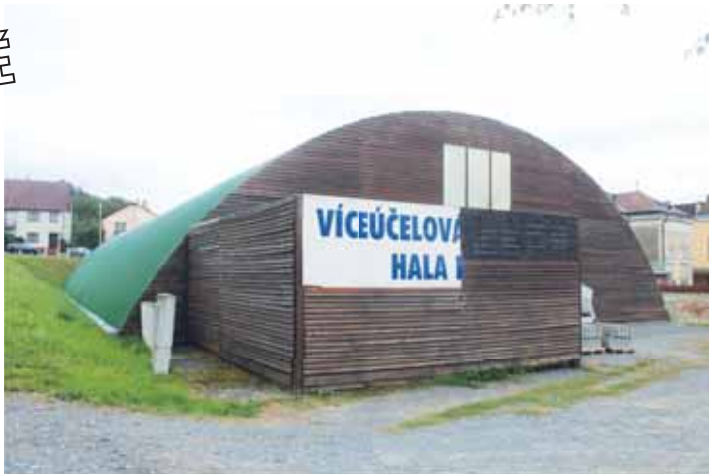
Stav víceúčelové haly v Konici je již po 15 letech provozu velmi špatný, bez potřebné rekonstrukce by hrozilo, že přestane fungovat i jako kluziště. Foto: Jan Frehar
