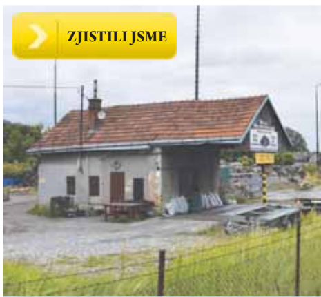
Prostor bývalých uhelných skladů se aktuálně nenachází právě v ideálním stavu. Stavbou nového supermarketu i s parkovištěm by jistě získal. Foto: Martin Zaoral
