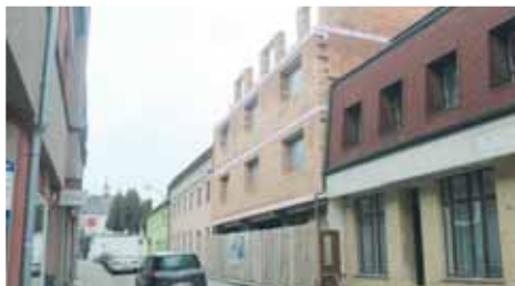
Parkoviště ve dvoře areálu Jednoty by v budoucnu měli využívat i noví majitelé některého z devíti bytů nemovitosti, která aktuálně vyrůstá v ulici E. Beneše. Dokončena by měla být už 30. listopadu příštího roku. Foto: Martin Zaoral
