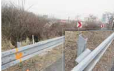
Policie hledá svědky nehody, kdy zatím neznámý řidič poškodil svodidla při sjezdu z dálnice. Foto: Policie ČR
