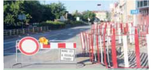
Wolkerova ulice je už více než měsíc uzavřena, přesto semaforey na blízké křižovatce fungují i nadále. Foto: Michal Kadlec
