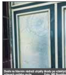
Dveře na hlavním nádraží utrpěly škodu po vzteklém výlehu opilého muže. Foto: MP Prostějov
